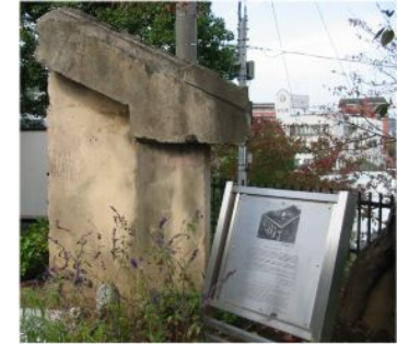
渚中学校旧体育館の外壁
